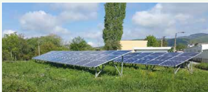
Solpaneler hos AQ Magnit, Bulgarien.
